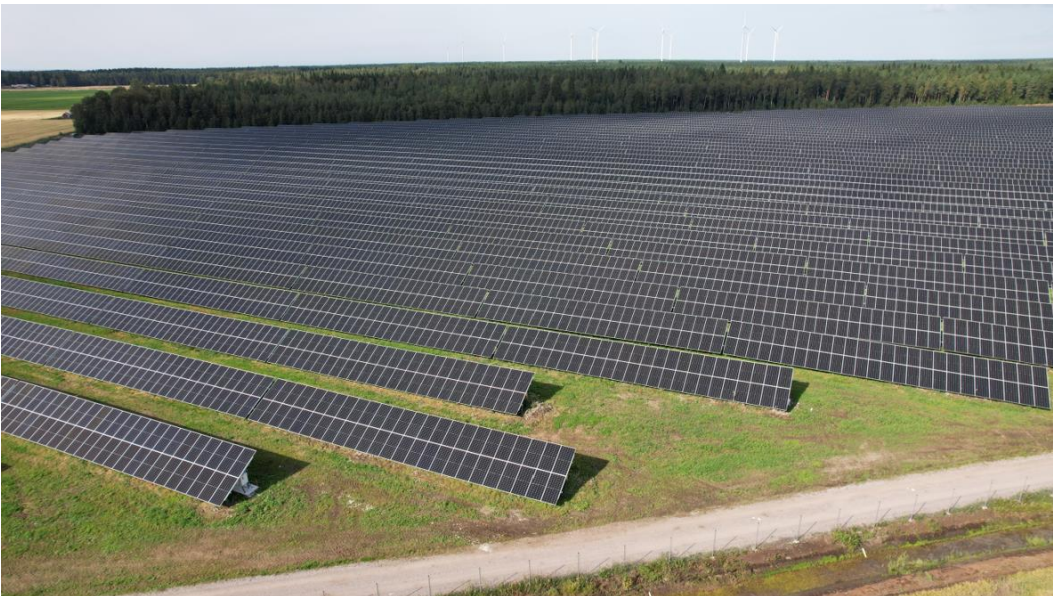
Kuva 3. Paneelirivistöt etelän suuntaan
